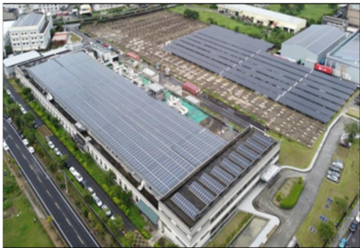
宜蘭廠屋頂型太陽能案場
